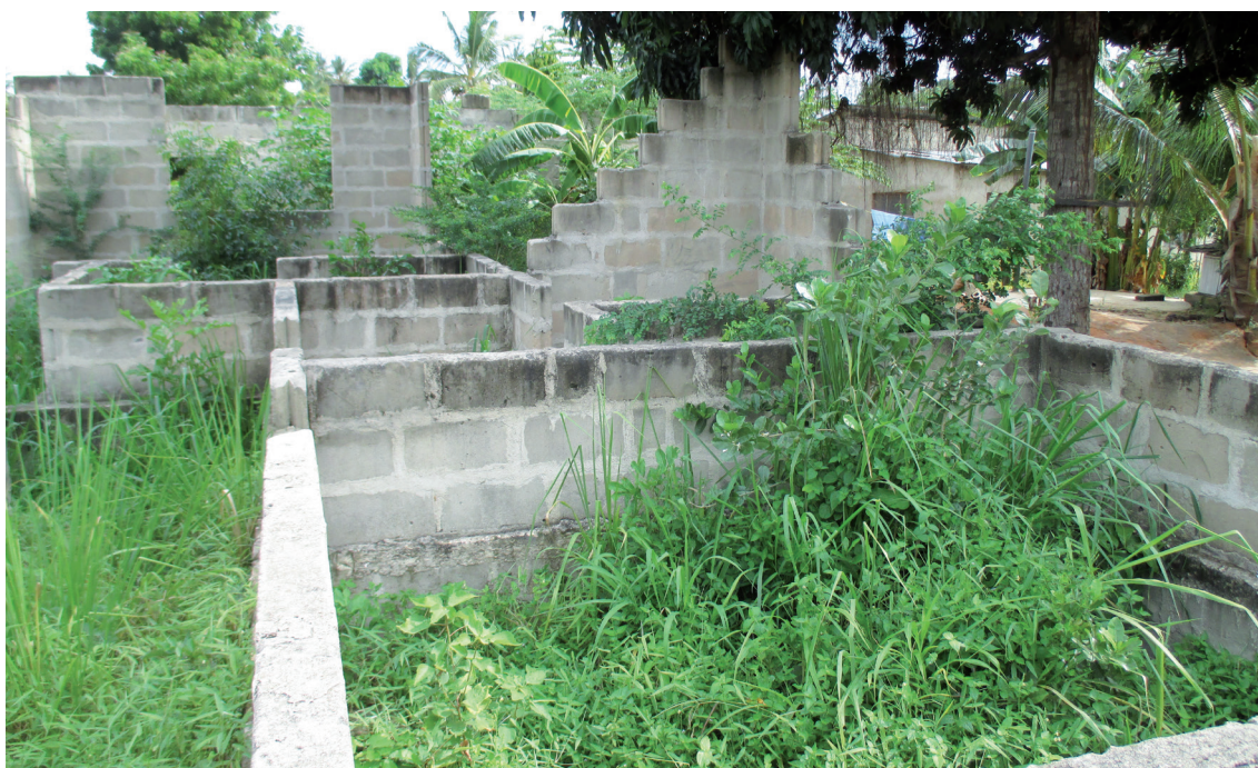
Lotissement et constructions abandonnées, Mapinga, district de Bagamoyo © S. Schlimmer, 2018
